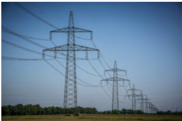
Огромные опоры, несущие линии электропередач по всей стране
